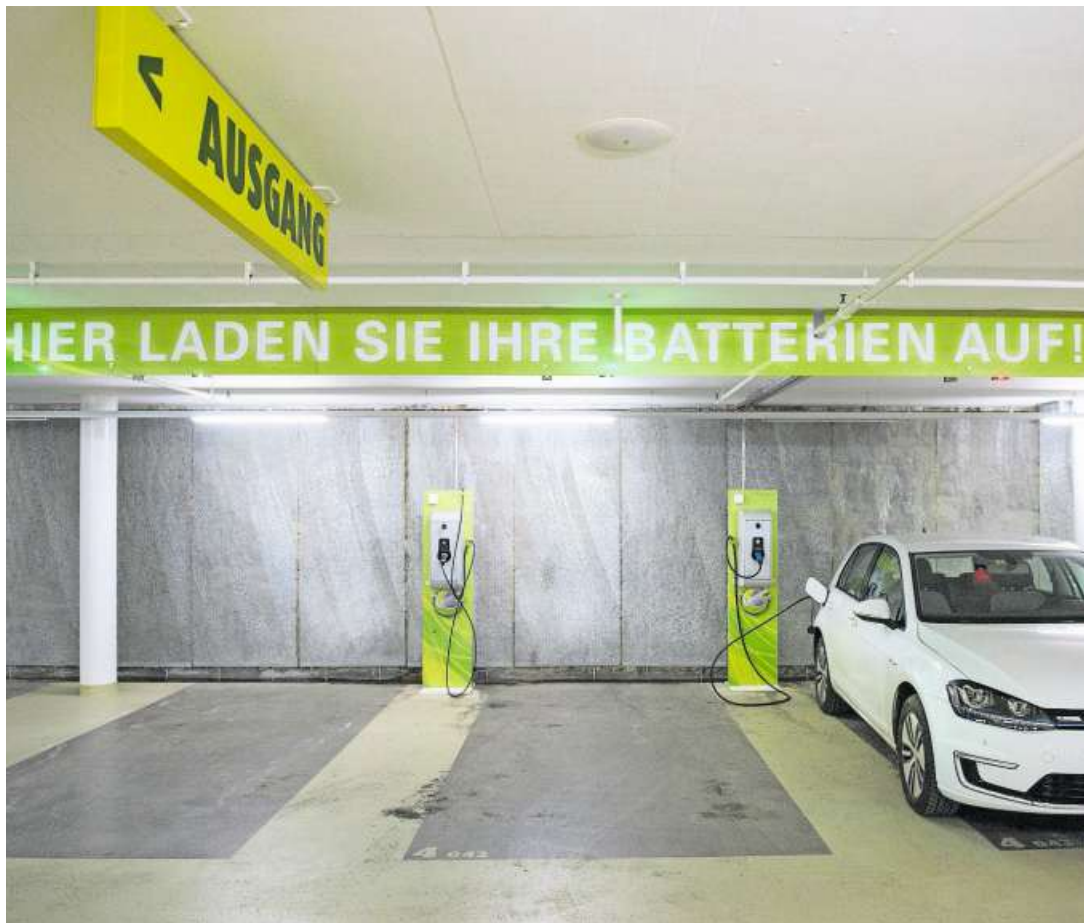
Elektroautos sind hierzulande noch nicht weit verbreitet.
